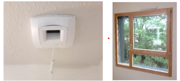
➤ Photos des bouches de ventilation et des grilles d'entrée d'air
