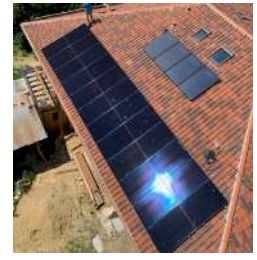
Solaire thermique et photovoltaïque en autoconsommation
