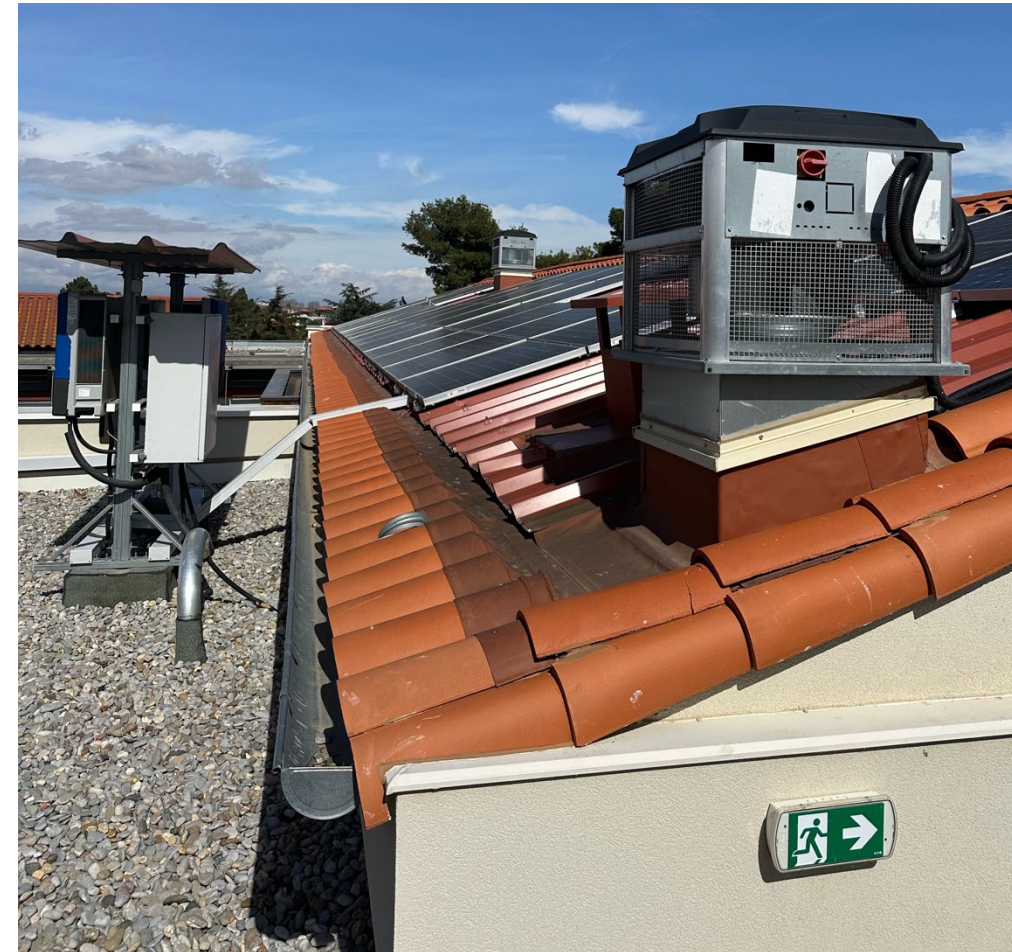
Toiture solaire et désenfumage
