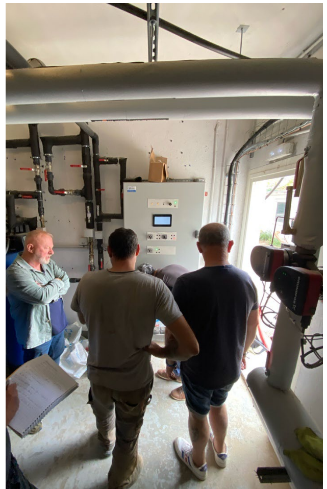
Réseaux ECS (solaire)
