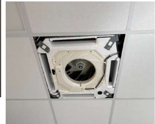
Cassette en plafond
