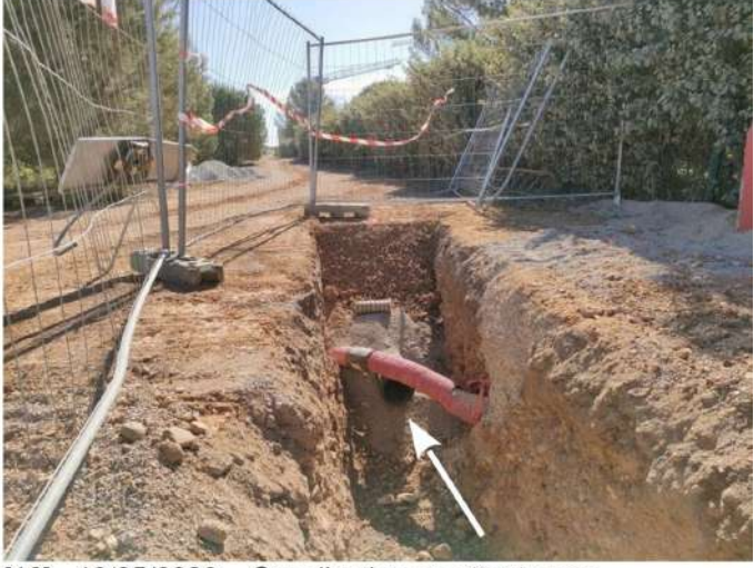
[16] - 10/05/2023 – Canalisation en attente non bouchonnée.
