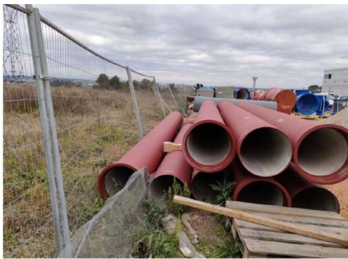
[17] - 15/02/2023 – Grillage petite faune endommagé.
