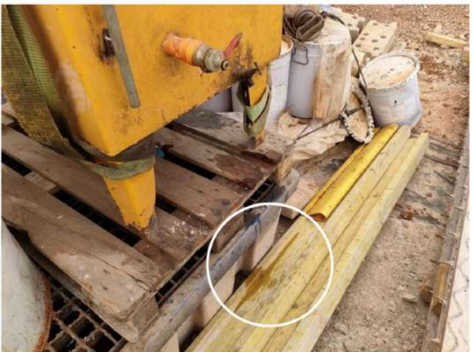
[21] - 12/04/2023 – Fuite de fluide polluant en dehors du bac de rétention.
