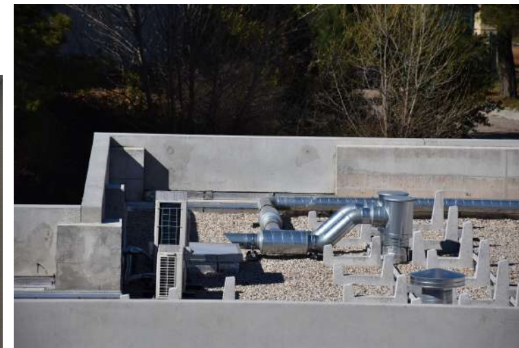
VRV en toiture Sortie VMC Plots en attente PV
