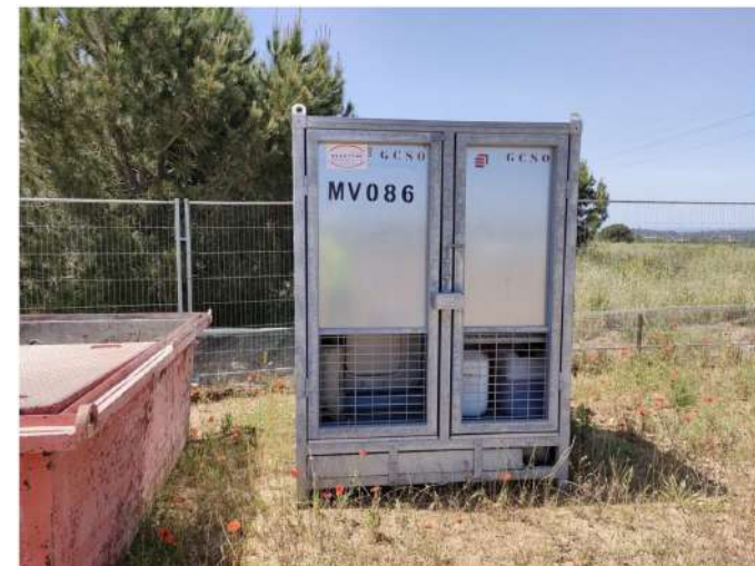
[4] - 19/05/2022 – Abri de stockage avec bac de rétention pour les produits polluants.
