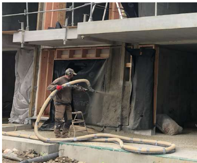
Photo 2 : Exemple de projection mécanique de béton de chanvre sur un coffrage perdu intérieur en plaque de gypse.
