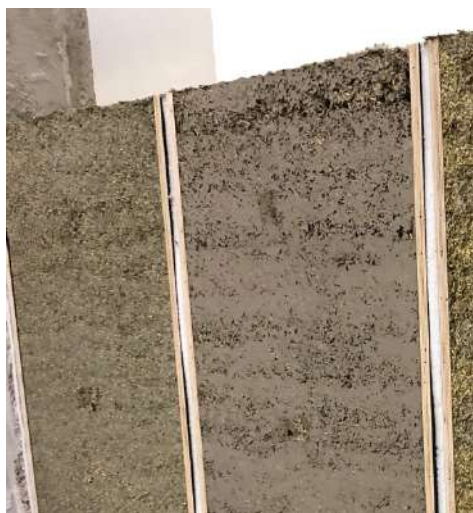
Photo 3 : béton de chanvre homogène sur sa surface.
